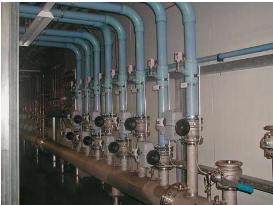
Moderne Druckluftverteilungen enthalten spaltlose Rohrverbindungen und zeichnen sich durch geringste Leckagen aus.
